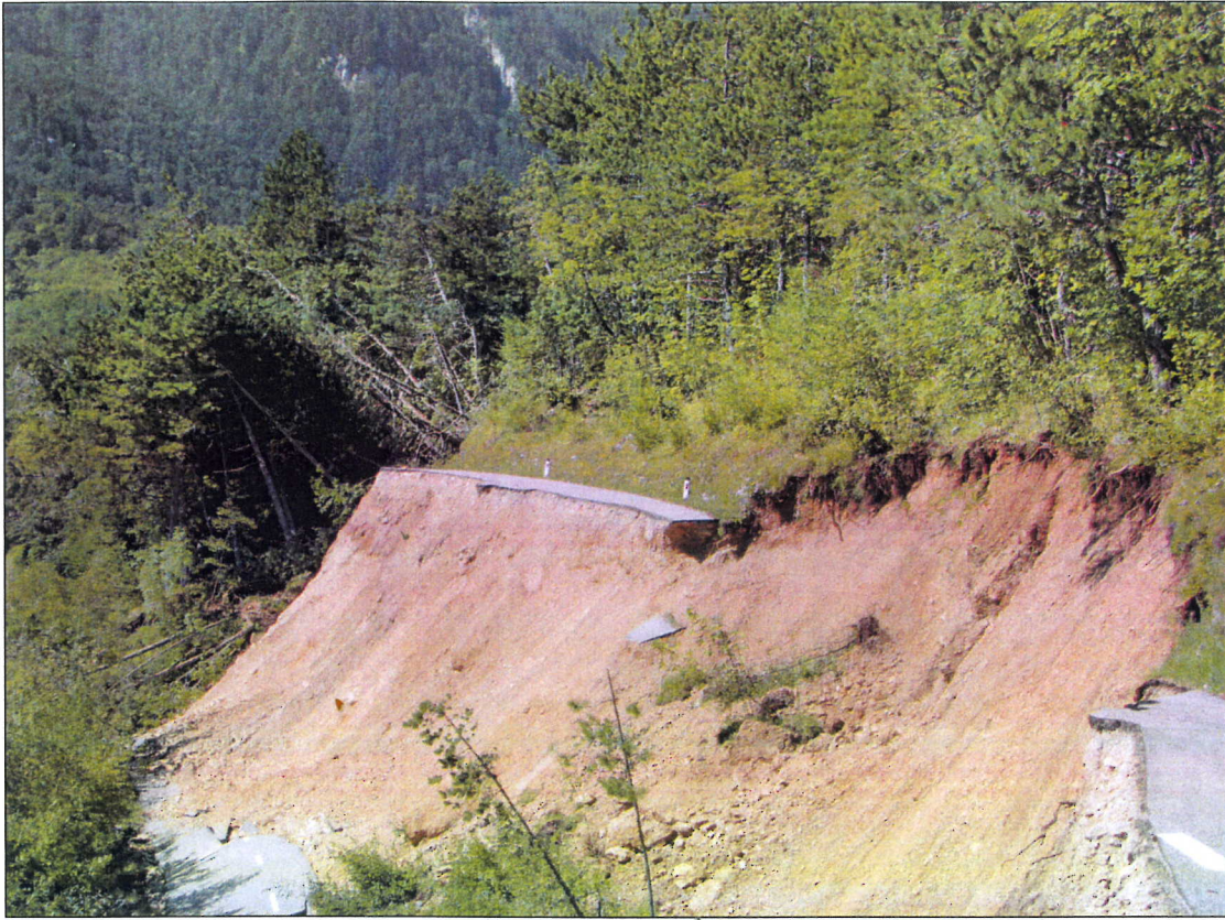
Lokacija: Plaz Stogovce na regionalni cesti R3-609 Lokavec-Predmeja
