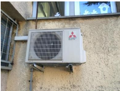
Slika 18: Klima naprava split
